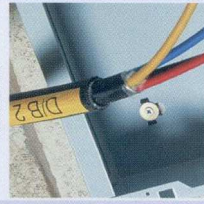
Przewody i kanały kablowe
