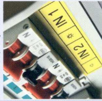
Skrzynki rozdzielcze i tablice połączeń
